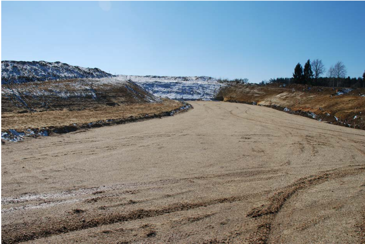
Bild 5: Vorbereitungen zum „Holzweg“ im Gewerbepark – bereits über eine halbe Million Euro in den Sand gesetzt
